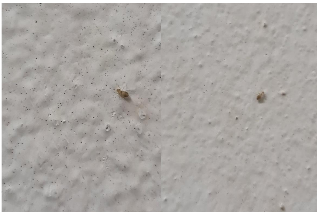
Obr. 6,7: Stav stěn v archivu, plíseň a pisivky na stěnách
